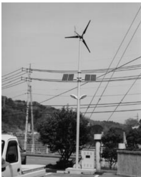
風力発電（飯富病院）
