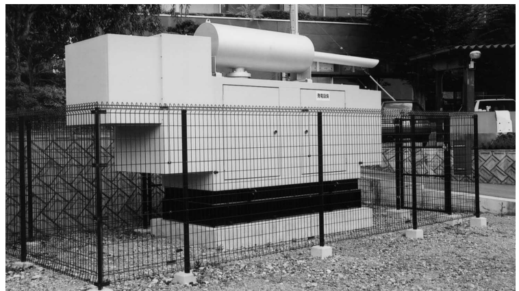
役場本庁舎の非常用発電機
