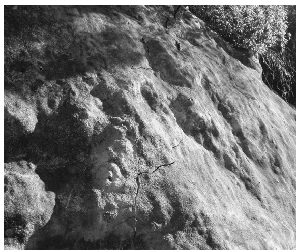
クラックが入った法面（西嶋大塩線）
