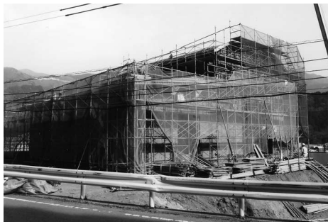
下水道大野処理場
