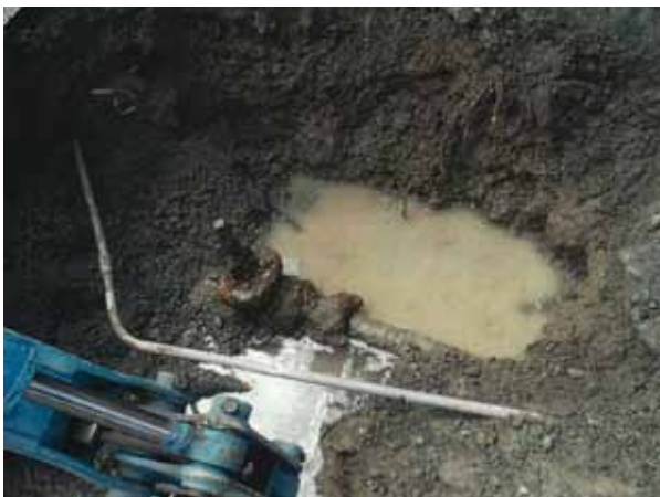
老朽化した水道管
