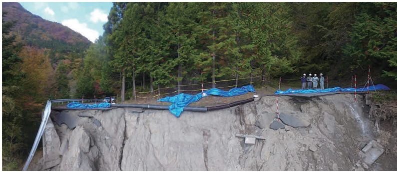
災害現場(矢細工地内)
