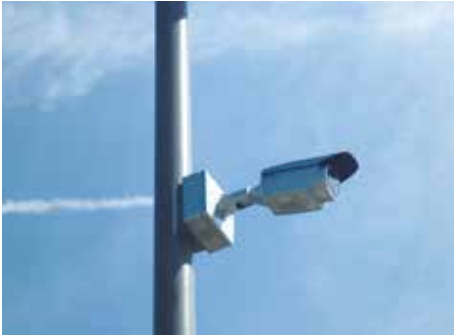
設置された防犯カメラ（役場駐車場）
