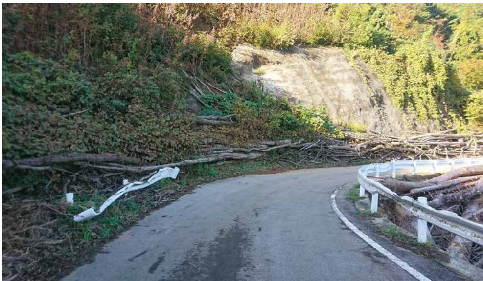
破損されたガードレール
