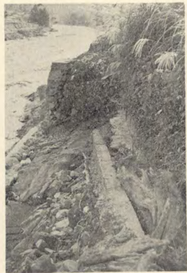
波木井三区 農業用水路破損（41年災害・波木井川）
